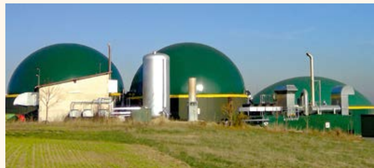
■ Biogasanlage Heilbachhof nach erfolgter Umrüstung auf den Flex-Betrieb. Foto: Christian Glahn
